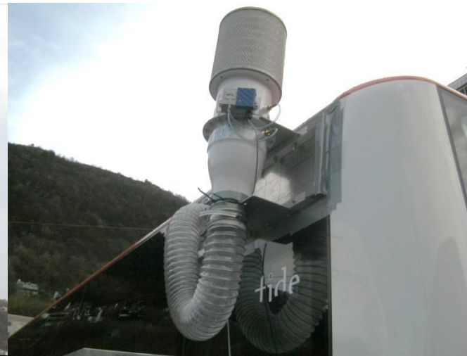
Luftmengdemåler montert over inntaket til motorens luftfilter
